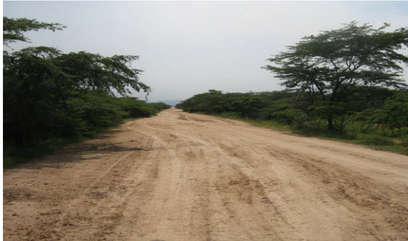
Fotografía 3: San Juan del Cesar- Badillo. Vía sin intervenir
